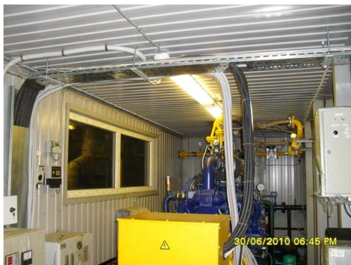
МЭС 200 в контейнере
