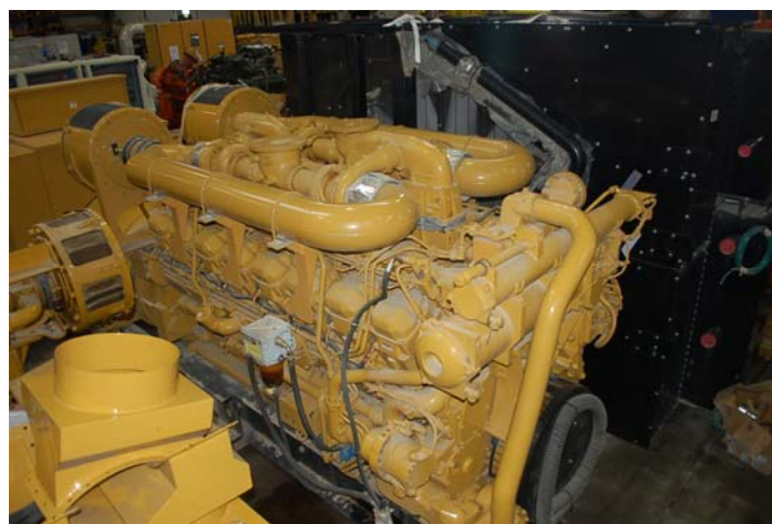
МЭС Catarpillar 3516 1MW
