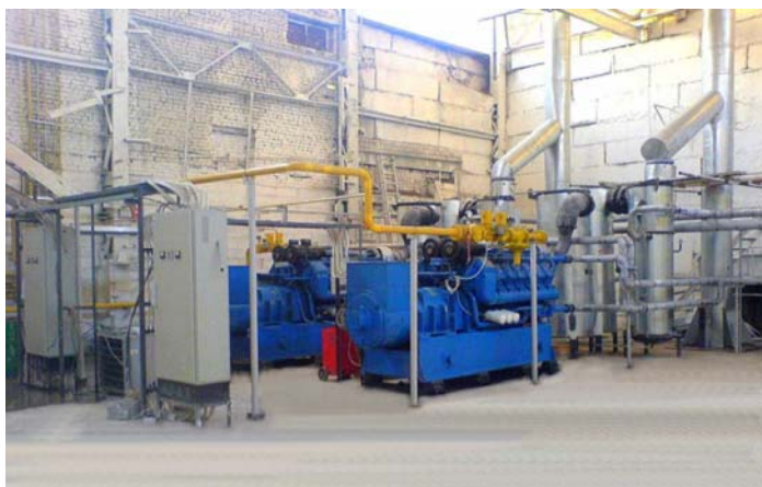
2 МЭС по 800 кВт завод «Метур» г. Екатеринбург
