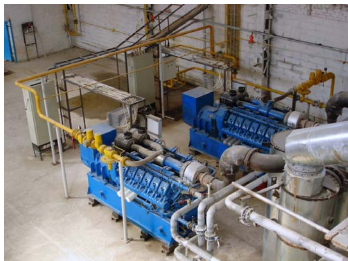
2 МЭС по 800 кВт завод «Метур» г. Екатеринбург
