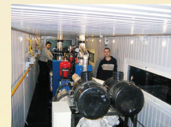
Наладочные работы в БКПЭА 400 (200+200) на базе ЯМЗ 240
